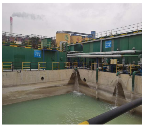
生产废水处理系统
