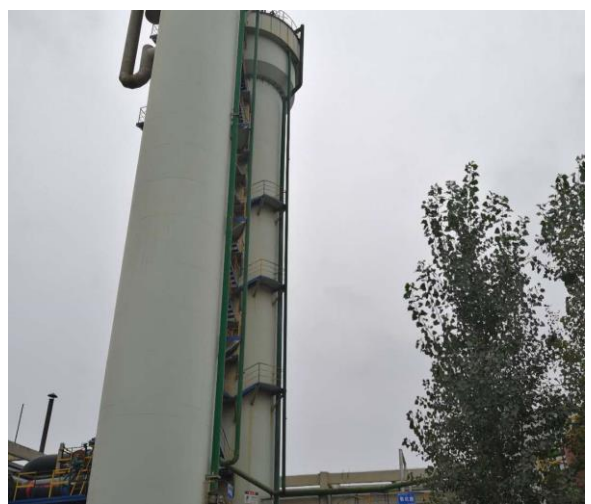
煤气站脱硫塔
